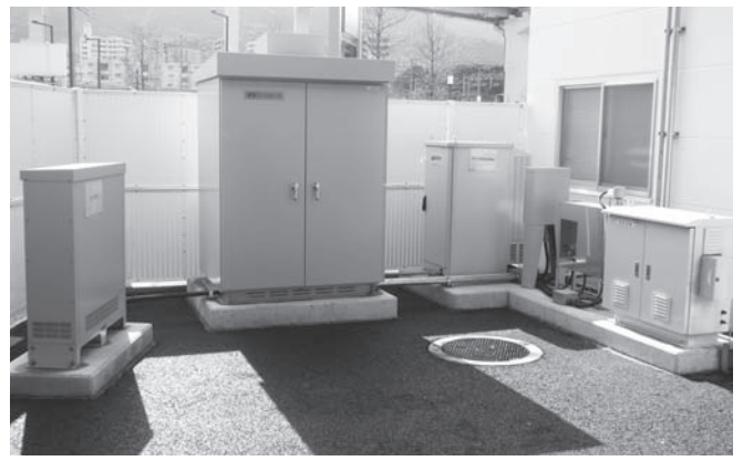
左から、蓄電池、蓄電コントローラ、3kW水素型燃料電池、脱臭装置
