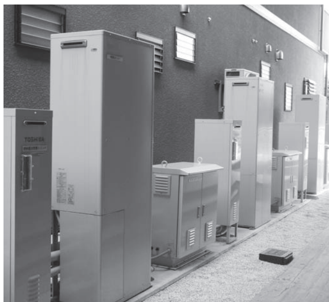
集合住宅の裏側。 左から、発電ユニット、貯湯槽、脱臭装置の順
