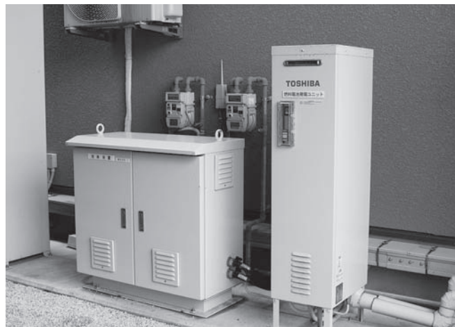
左から、脱臭装置と発電ユニットの拡大写真
